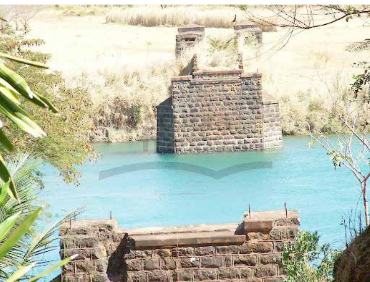
Pilares da Ponte Afonso Pena na região do Caidor - a primeira estrada e o porto
