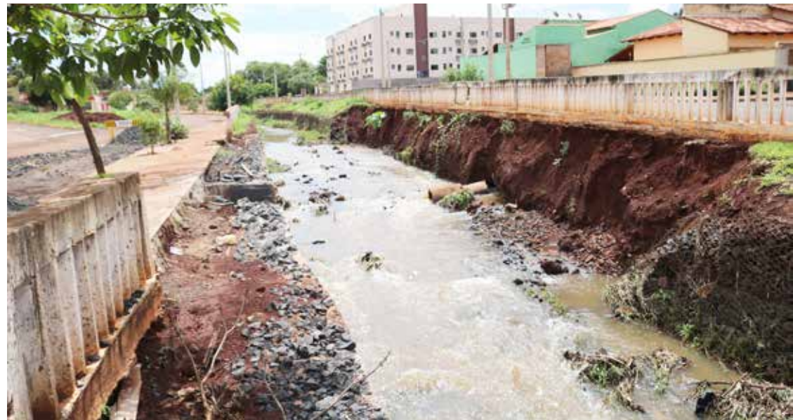
Trecho do Córrego Água Suja, que cedeu em fevereiro deste ano e estava sendo recuperado e a outra parte que caiu com as chuvas desta semana
