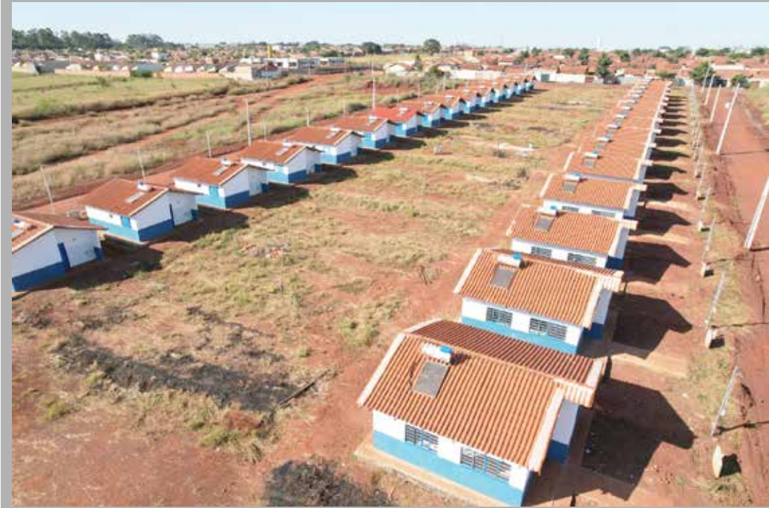
Construção de 30 casas populares no conjunto Messias Faria, na região norte da cidade
