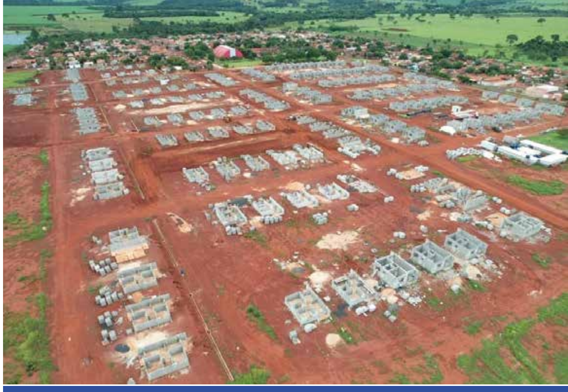
170 MORADIAS Conjunto Radivair Miranda Machado em obras. Investimento de R$ 21 milhões (Estado) e R$ 14 milhões (Prefeitura). Total R$ 35 milhões
