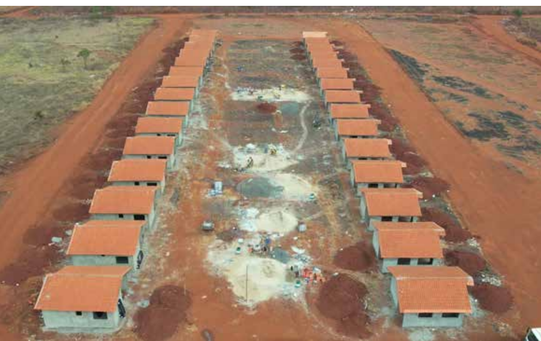
Obras de construção de 30 moradias no conjunto Messias Faria, na região norte
